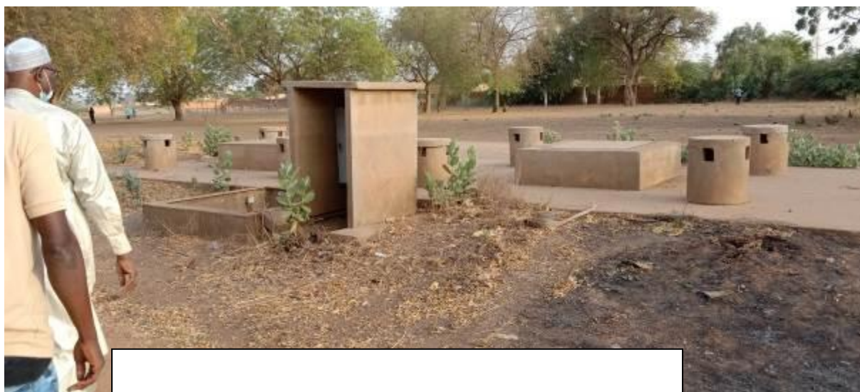
Photo 5 : Station de traitement des eaux de l'EMIG
