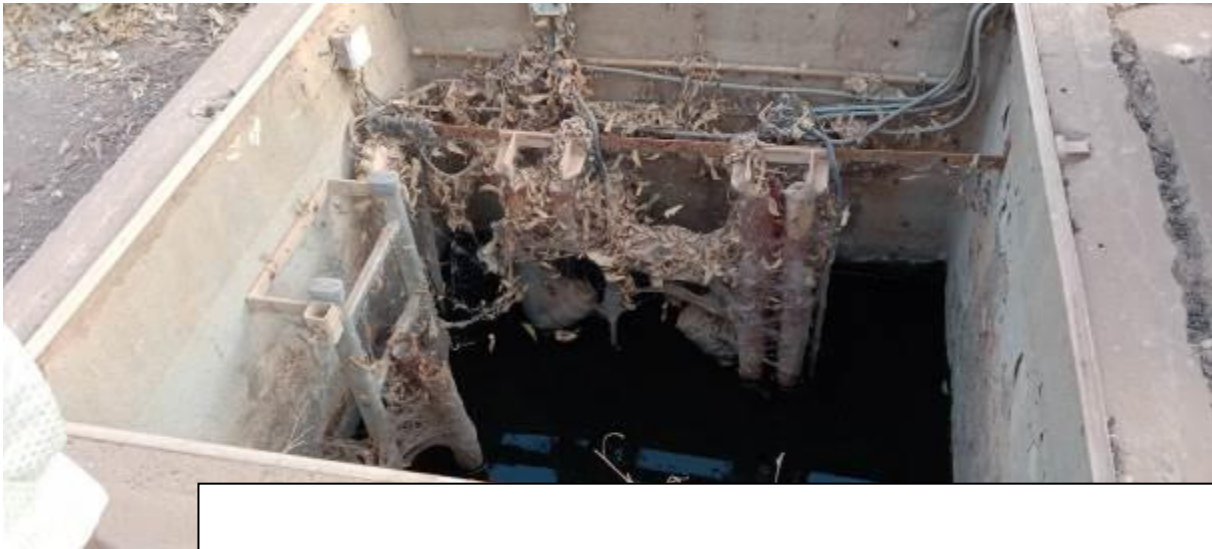
Photo 6 : Station de traitement des eaux usées del'EMIG
